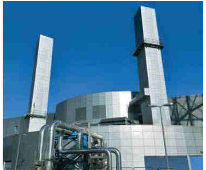
Sopra: la centrale di cogenerazione "Canavese" di Milano.
