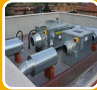
Elettroventilatori a tetto
