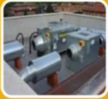
Elettroventilatori a tetto
