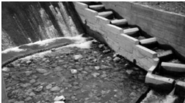
Foto 7.14: Scala con fessure verticali
