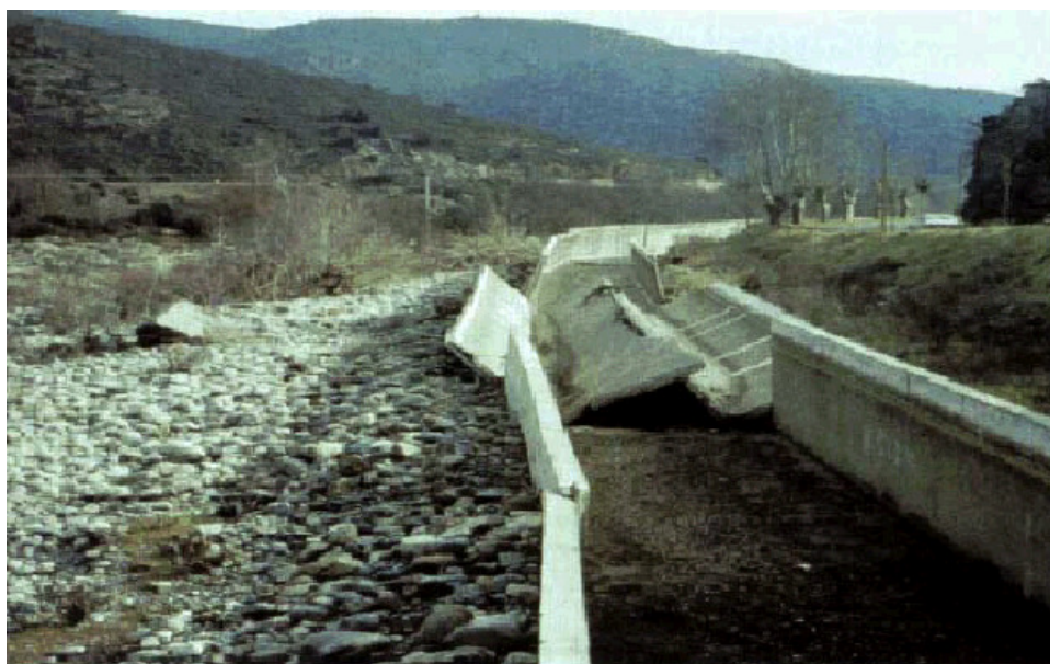
Foto 4-12 Il canale distrutto per effetto delle sottopressioni
