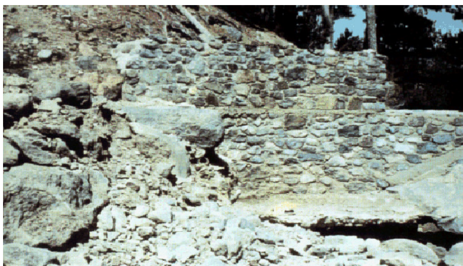
Foto 4.11: la traversa compromessa dalle infiltrazioni
