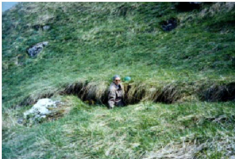
Foto 4.3: Scarpata in fase di scivolamento già prima dell'inizio dei lavori
