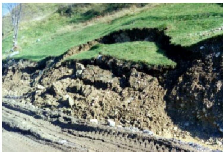
Foto 4.2: Instabilità locali provocate nel corso dei lavori di scavo
