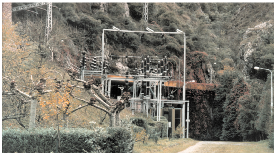
Foto 7.18 Impatto visivo di una sottostazione all'aperto
