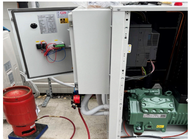
Vista interna Condensing Unit e prima carica impianto
