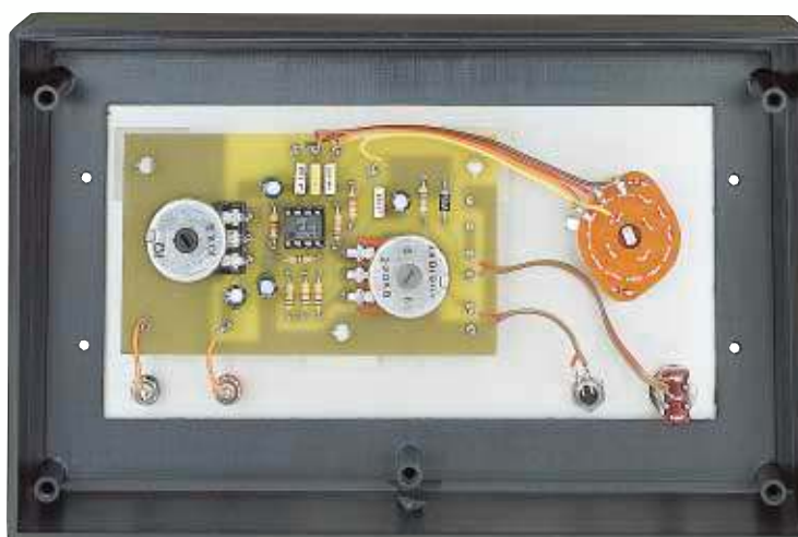
Fig.135 La scheda LX.5031 montata all'interno del suo mobile plastico. Il commutatore rotativo S1, da utilizzare per il cambio gamma, andrà fissato sul pannello frontale.
